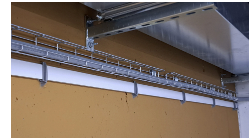
An der Wand installiert
